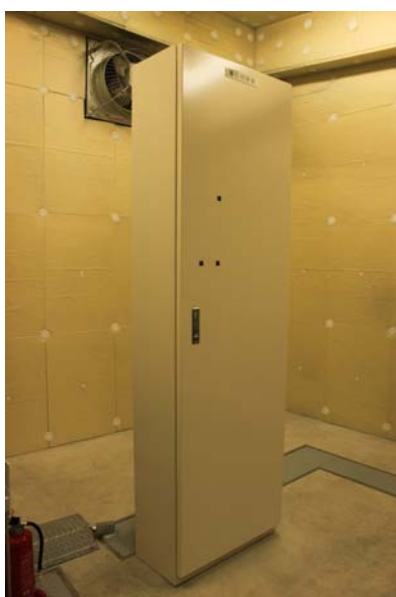
図 5-4 道の駅三本木(宮城県)の自動切替装置
