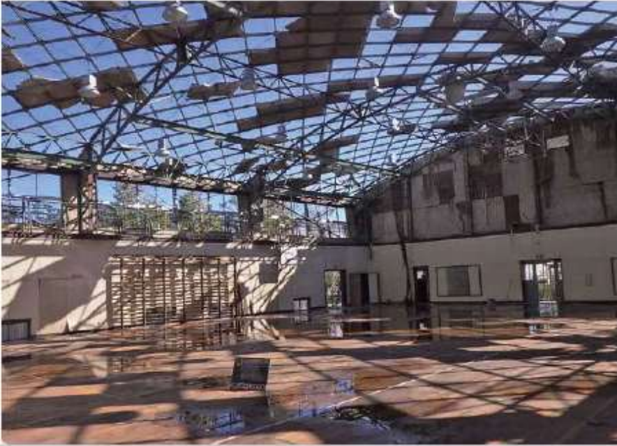
屋根が吹き飛んだ体育館
