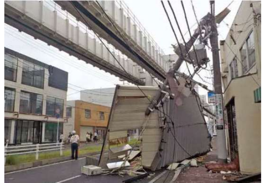
道路上に倒壊したプレハブ
