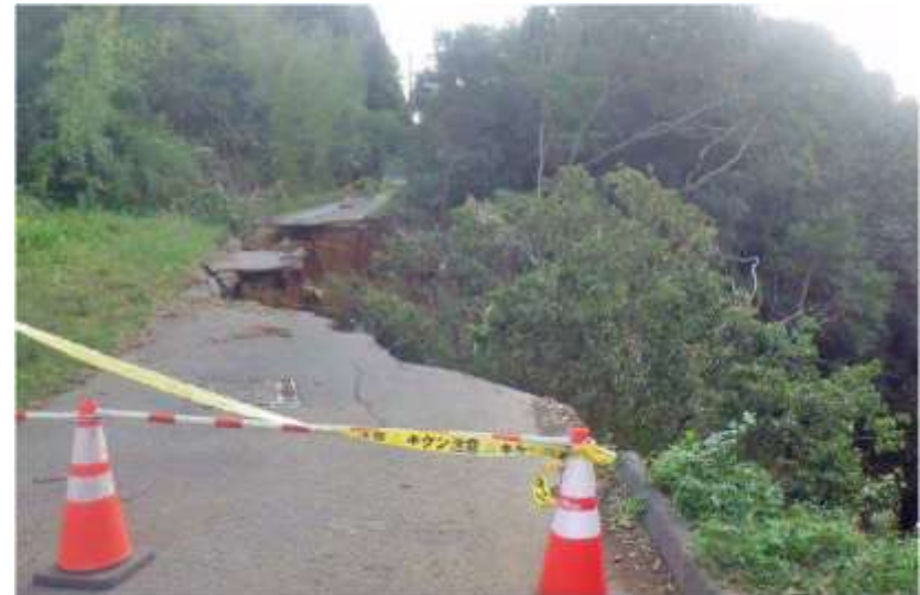
崖崩れにより分断された道路
