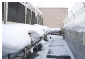
個別分散型空調機器の設置状況 (北海道旭川市)
